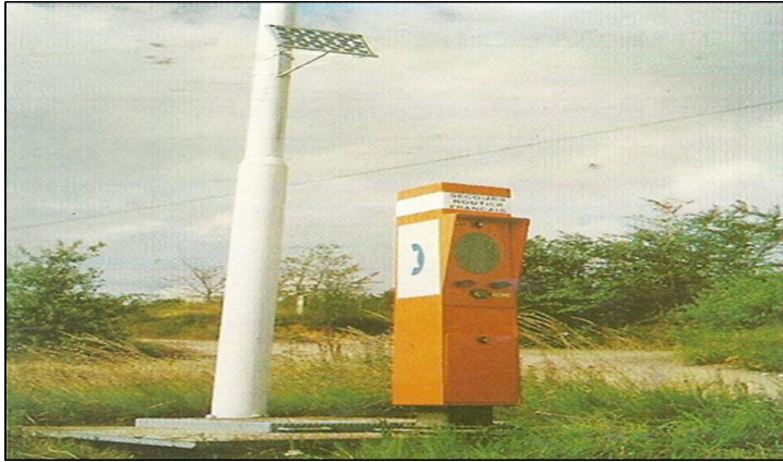
شكل (٢٥-٣): يمثل تلفون طوارئ في طرق النقل الخارجية يعمل بالخلايا الشمسية.
